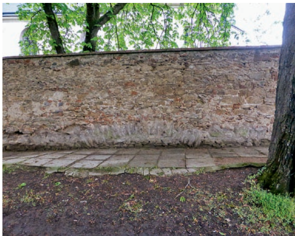
Obr. 120: Základový pas v neúnosném místě podloží (Kaňk).
