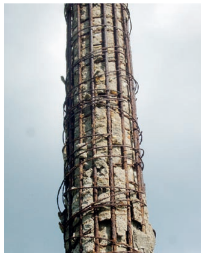
Obr. 44: Železobetonový sloup elektrického vedení zničený korozí, Rokytovec, 30. léta 20. století.
