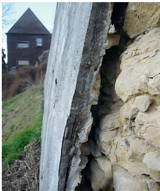
Obr. 37: Cementový nástřík na zdi z opuky, Praha Hradčany.
