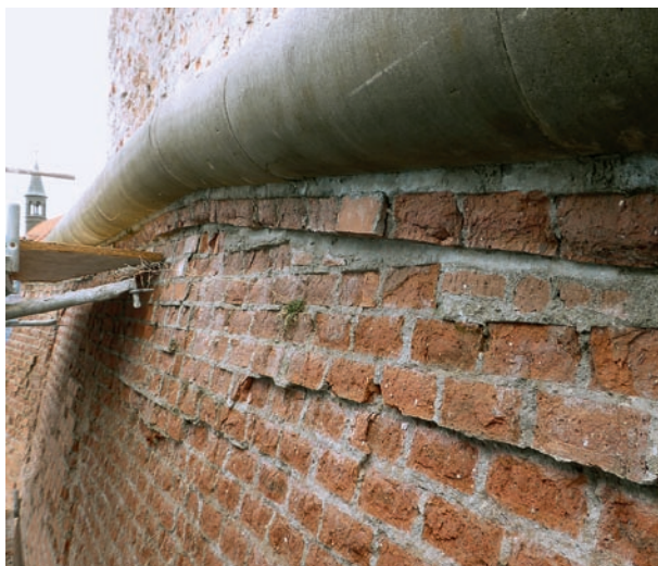
Obr. 52: Degradace slínutých cihel spárovaných cementovou maltou, Praha Pohořelec.
