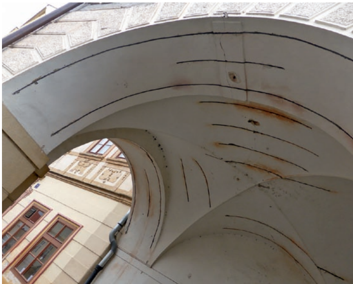
Obr. 28: Pro obnovení únosnosti klenby je především nutné zajistit přenos tlaku – tedy co nejlépe vyplnit trhliny hloubkovým vyspárováním – k tomu zde nedošlo. Osazení šroubovicové výztuže do drážek v omítce nezabrání působení tahových a smykových sil, ke zvýšení únosnosti kleneb nepřispívá, je však výrazným zásahem do autentických poruchů, Praha Pohořelec
