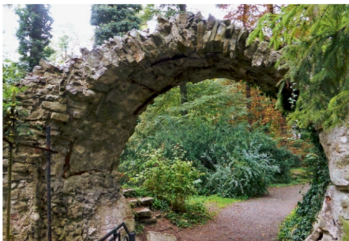
Obr. 102: Klenba z lomového kamene v umělé zřícenině, vyztužená železem, Kroměříž, 19. stol.
