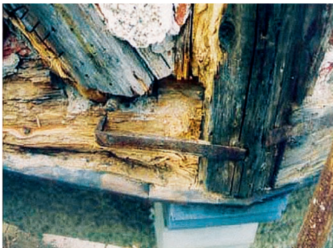
obr. 134: Měděné oplechování neochránilo dřevěné proky hrázdění před napadením tesaříkem, hrad Konopiště.
