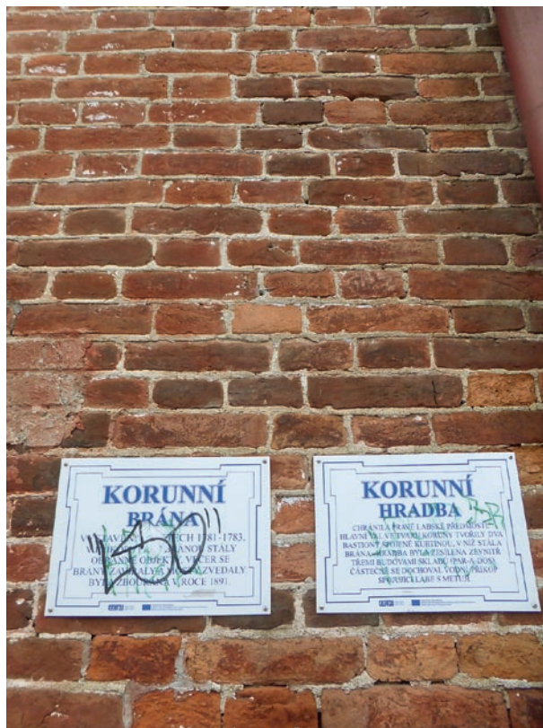
Obr. 53: Původní spárování vystupující před líc barokní hradby, Josefov.
