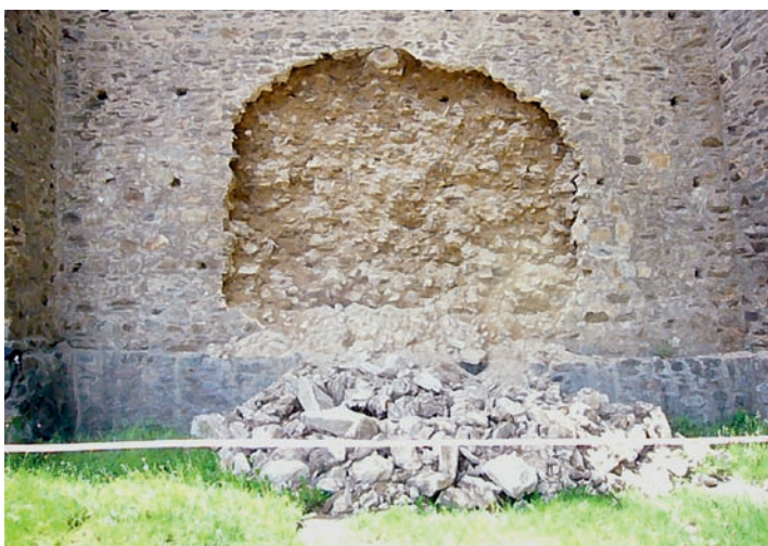
Obr. 49: Hradba z lomového zdiva, která tvoří líc zemního násypu, byla vyspárována cementovou maltou. Utěsněný líc zadržoval vodu pronikající z násypu, působením vlastní tíhy se narušený líc zřítíl. Hrad Klenová.
