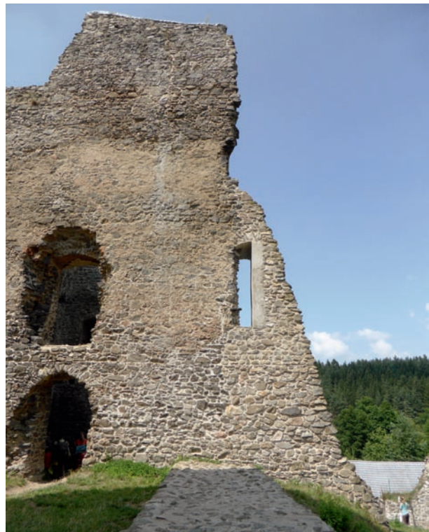
Obr. 47: Možnosti zajištění stability převislých prvků zříceniny, hrad Rokštejn.
