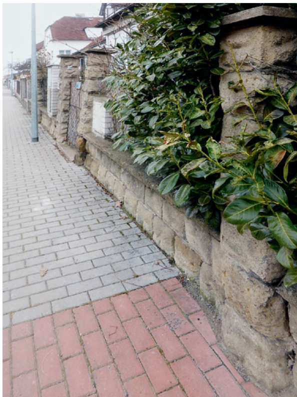
Obr. 42: Narušení stability opěrné zdi způsobené mrznutím zeminy. Úroveň chodníku je nižší než terén zahrady, parapet plotu má malou tloušťku a je mělce založen, nejbližší sloupek má tak velký úklon, že došlo ke vzniku tahové trhliny v ložné spáře – bezprostředně hrozí zřícení. Tato závada je u zděného oplocení velmi častá, proto se musí dodržet předepsaná hloubka založení, opěrná zídka musí mít dostatečné dimenze a její rub musí být odvodněn, Praha Ruzyně, 70. léta 20. století.
