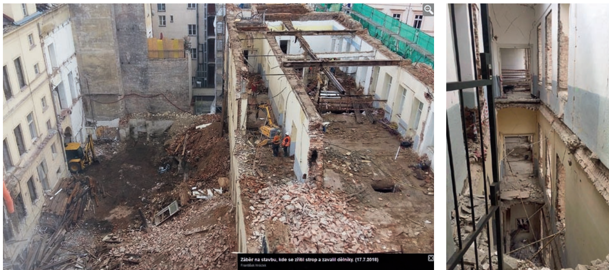
Obr. 12: Havárie pražského domu, ke které došlo v důsledku nekvalifikovaného návrhu a postupu práce.
