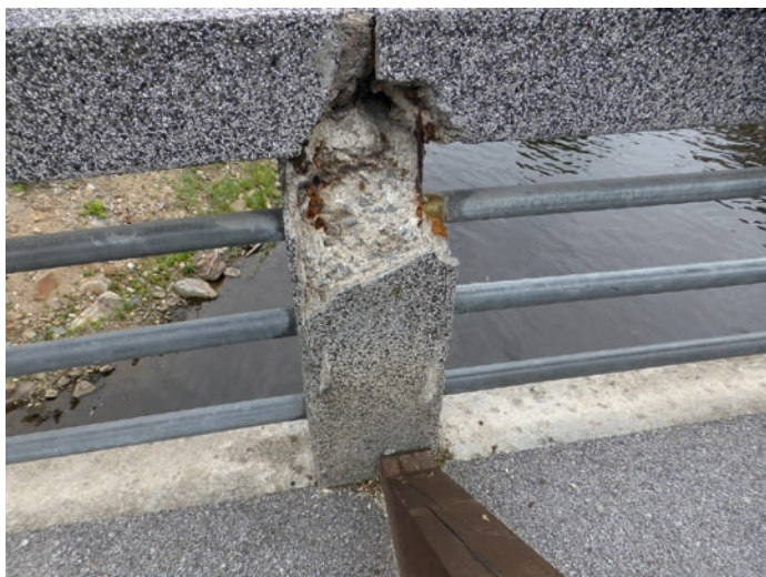
Obr. 43: Zábradlí mostu z umělého kamene silně narušené korozí úvaztu, Český Krumlov, 30. léta 20. století.
