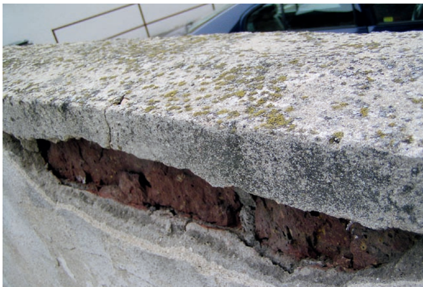
Obr. 38: Monolitická koruna bez dilatačních spár, smršťovacími trhlinami zatéká do zdiva – nástřík stěny cementovou maltou je odtržen, Jihlava.
