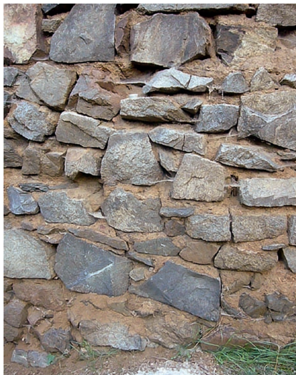
Obr. 26: Tahové trhliny při nároží, Zlenice
