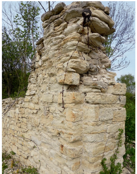
Obr. 178: Zdivo z měkké místní opuky špatně odolává působení povětrnosti. Exponované části zdi (nároží, ostění) byly proto vyzdívány z kvádrů, koruna byla kryta masivními deskami z pískovce a oba líce zdi byly omítané. Dnešní stav byl způsoben zanedbáním údržby. Obnova zdi bude velmi obtížná, řešením není dozdivování nebo omítání cementovou maltou. Viniční zdi, Liběchov
