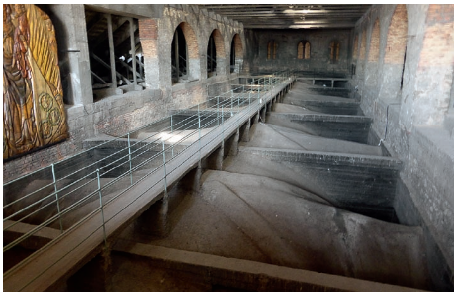
Obr. 107: Klenby zničené při bombardování v roce 1945 byly obnoveny ze železobetonu, poškozené klenby byly zesíleny podle návrhu prof. B. Hacara, klášter Na Slovanech, Praha.
