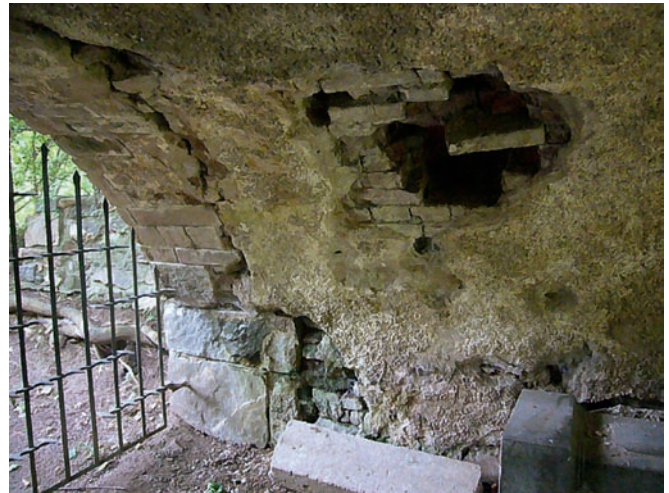
Obr. 115: Poruchy způsobené zatékáním do zdiva při parapetu a zadržováním vody nad patkou klenby, zděný most, Konopiště.
