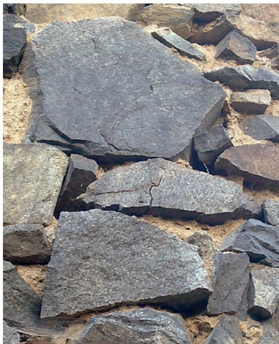
Obr. 24: Porušení pevného kamene smykem v lomovém zdivu s nepravidelnými spárami, Zlenice
