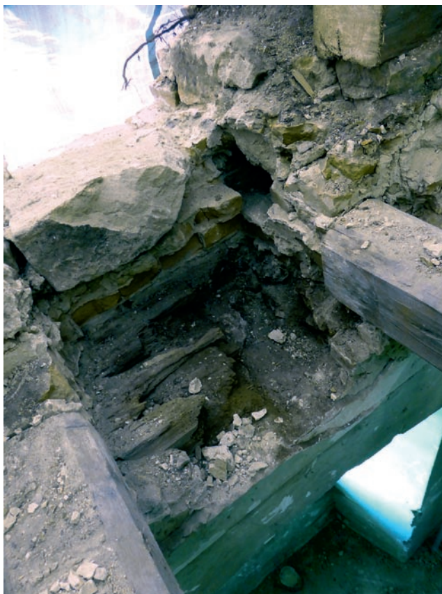
Obr. 142: Uložení vazných trámů po odkrytí: narušené zdivo, degradovaná pozednice, napadení dřeva, zazděné dřevěné prvky, nestabilní římsa, Zákupy.
