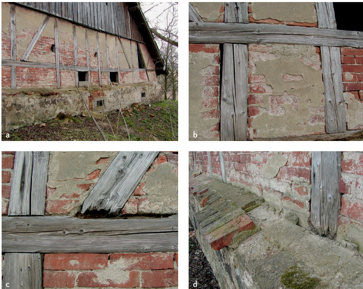
Obr. 166: Typické poruchy hrázděného zdiva: a – stodola, Opálka, 19. století; b – vysychání dřeva, uvolnění výplně; c – uhníování spojí; d – hniloba ve styku se soklem.
