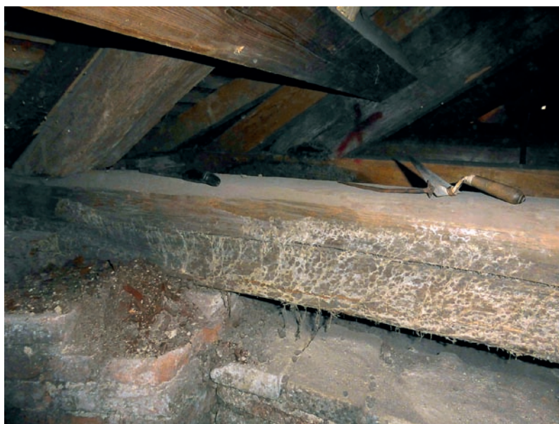
Obr. 136: Nově osazené vazné trámy krovu krátce po opravě napadla dřevomorka šířící se z uložení pozednic, které nebylo vyčištěno a sanováno. Rychlý rozvoj napadení umožnil zásyp z agloporitu, který houbě vytvořil prostředí se stálou vlhkostí a teplotou (projektant vycházel z mylné představy, že mezerovitý násyp umožní odvětrání vlhkosti). Dřevo přijímá vzdušnou vlhkost, která se v něm ukládá v kapalném stavu – pro odvětrání vody ze dřeva musí dojít k přeměně na páru, k tomu je nutné dodat skupenské teplo – tedy dřevo ohřát. Tento proces probíhá ve volném prostředí, násyp nebo zaždění dřeva odvětrání brání. Hospodářský dův v Plasích
