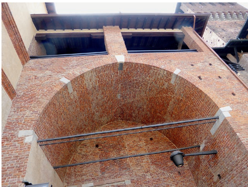
Obr. 78: Cihelná klenba s pískovcovými klenáky v nejvíce zatížených místech (patky, nebezpečný průřez, závěrečný klenák), brána vévodského paláce, Milán, 15. stol.
